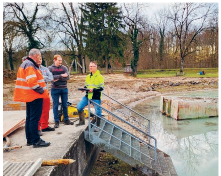
An den wöchentlichen Bausitzungen werden Fortschritte, Prioritäten, neue Erkenntnisse und unerwartet aufgetretene Probleme besprochen. Im Bild zu erkennen sind von links: Stefan Geiges, Bauführer, Yanick Stauer, Thurgauer Wildwasserfahrer, und Kaspar Fröhlich, Bauleiter.
