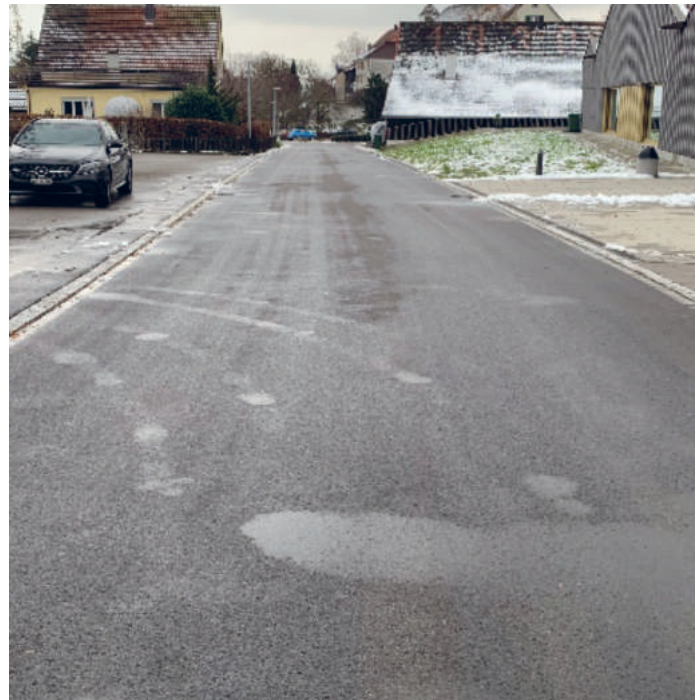
Aufgrund von Werkleitungsarbeiten wurde ein erster Teil der Berglistrasse saniert. Der zweite Teil wird in den kommenden Jahren folgen.
